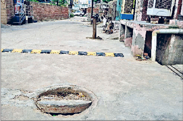
झज्जर। शहर के बेरी गेट क्षेत्र में धंसा सीवरेज का मेनहॉल।
